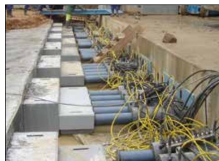
▲ Hincado de cajones: Sistema sincronizado de múltiples puntos para empujar hidráulicamente los segmentos del túnel por debajo del ferrocarril.
